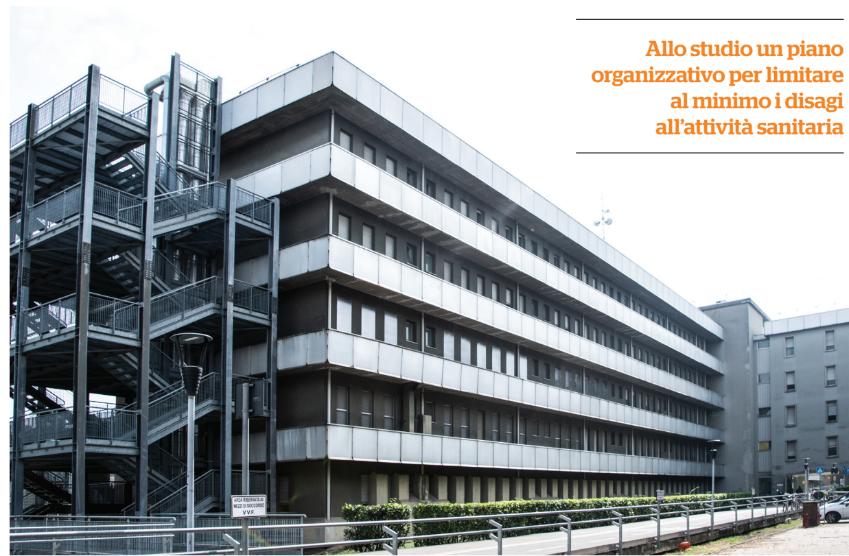
Il blocco C dell'ospedale Carlo Poma di Mantova, che per tre anni sarà interessato da lavori di ammodernamento
